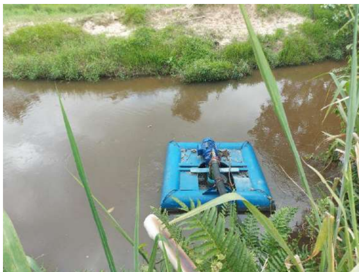
Figura 81 – Captação SAA de Rondominas.
