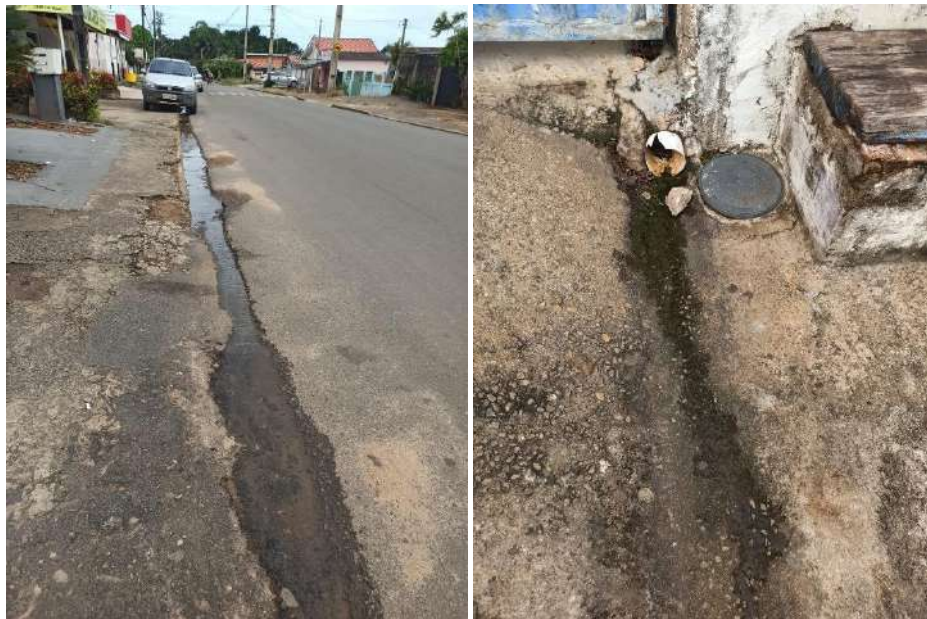
Figura 102 – Lançamento de águas cinzas na avenida Ademir Ribeiro.
