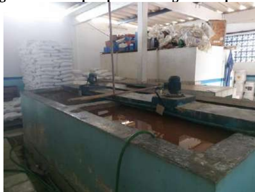
Figura 54 – Tanques para a dosagem dos químicos.
