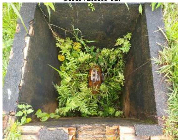
Figura 62 – Registro Gaveta DN 200 mm do tubo de saída do primeiro compartimento do reservatório 01.
