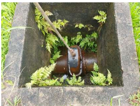
Figura 63 – Registro Gaveta DN 200 mm do tubo de saída do segundo compartimento do reservatório 01.
