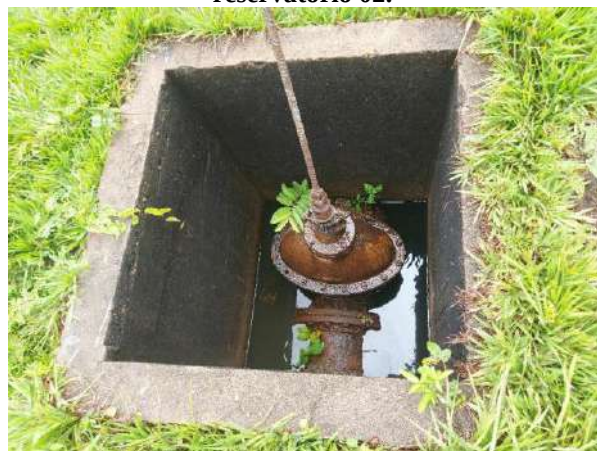
Figura 65 – Registro Gaveta DN 200 mm do tubo de saída do primeiro compartimento do reservatório 02.
