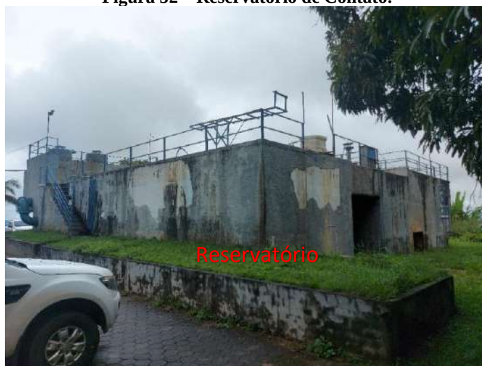
Figura 52 – Reservatório de Contato.
