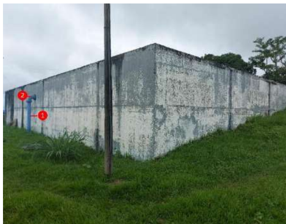
Figura 64 – Alimentação do Reservatório 02.
