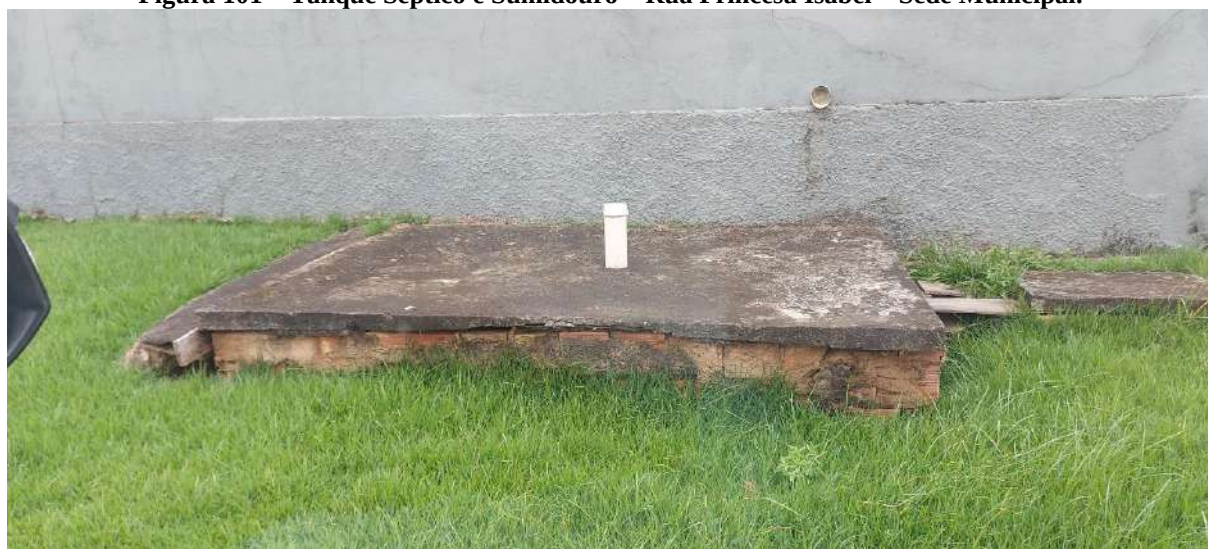
Figura 101 – Tanque Séptico e Sumidouro – Rua Princesa Isabel – Sede Municipal.
