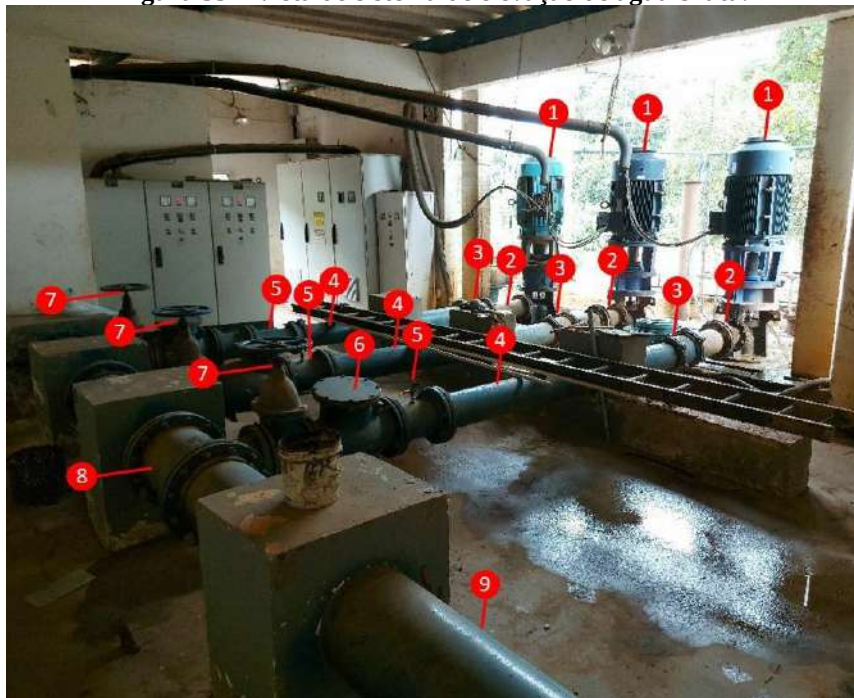
Figura 33 – Vista do sistema de elevação de água bruta.
