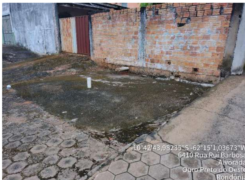
Figura 99 – Fossa rudimentar instalada na Rua Rui Barbosa – Sede Municipal.
