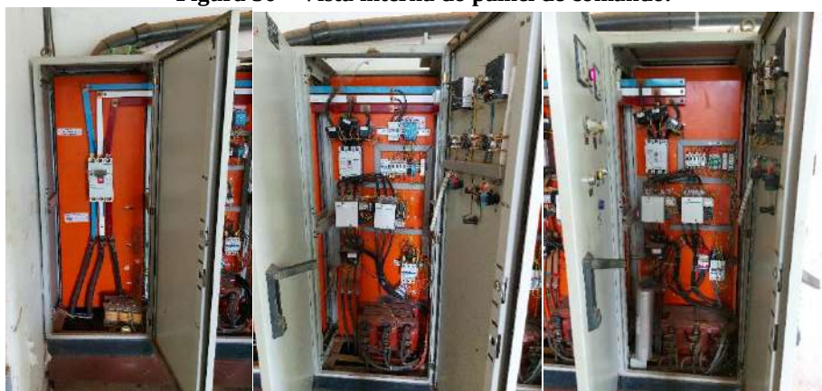
Figura 36 – Vista interna do painel de comando.
