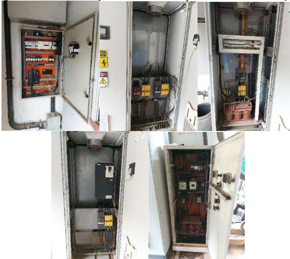
Figura 38 – Vista externa do painel do inversor de frequência e sistema de automação.
