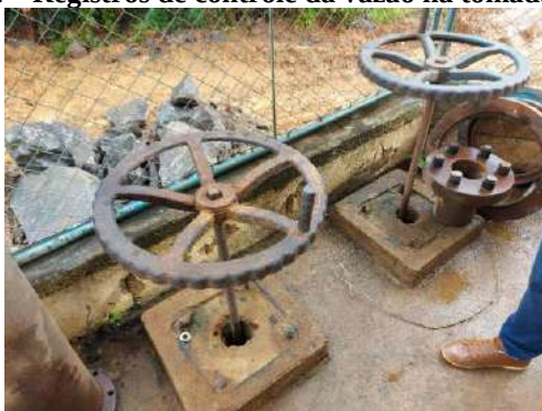
Figura 32 – Registros de controle da vazão na tomada de água.
