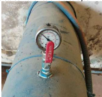
Figura 34 – Vista do manômetro na tubulação F°F° DN 300 mm.
