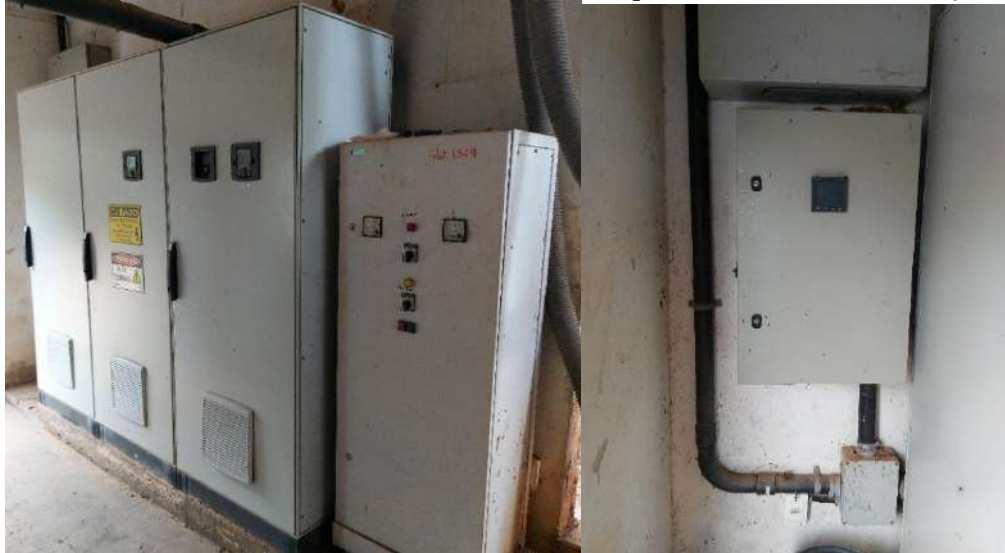
Figura 37 - Vista externa do painel do inversor de frequência e sistema de automação.
