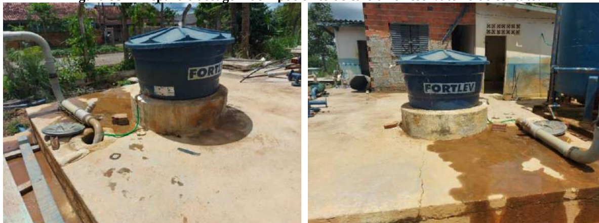
Figura 93 – Preparo e dosagem de hipoclorito de cálcio no reservatório de contato.
