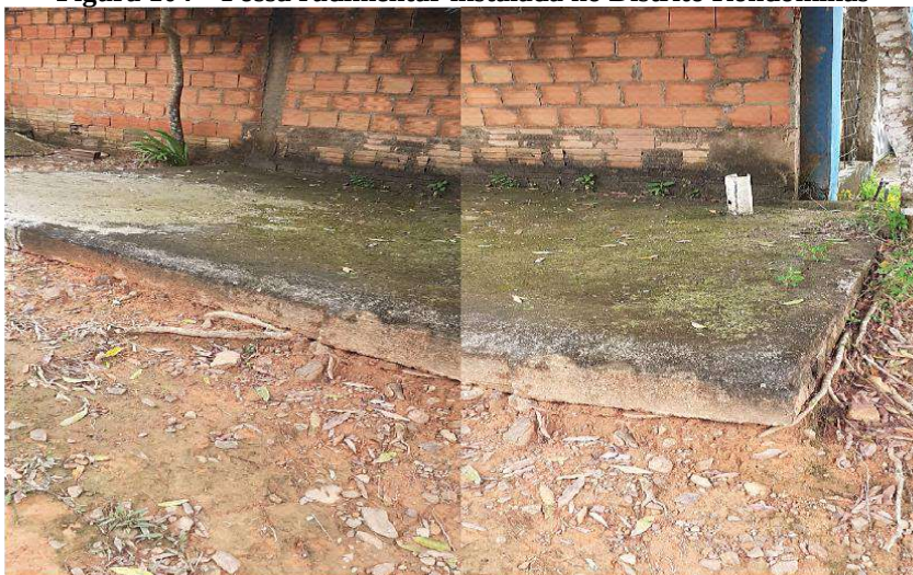
Figura 104 – Fossa rudimentar instalada no Distrito Rondonias
