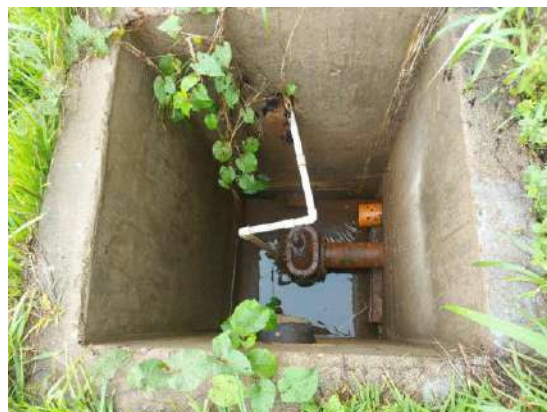
Figura 68 – Registro de descarga do reservatório 02.
