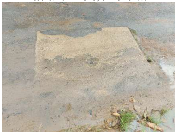
Figura 71 – Local do registro de manobra de gaveta DN 50 mm na rua Jucelino Kubtscheck, coord. 10°42'43"S; 62°15'28"W.
