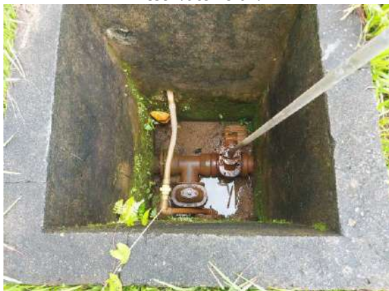
Figura 67 – Registro de descarga do reservatório 01.
