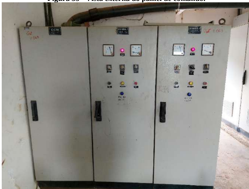
Figura 35 - Vista externa do painel de comando.
