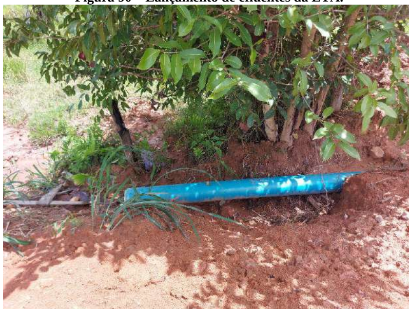
Figura 90 – Lançamento de efluentes da ETA.
