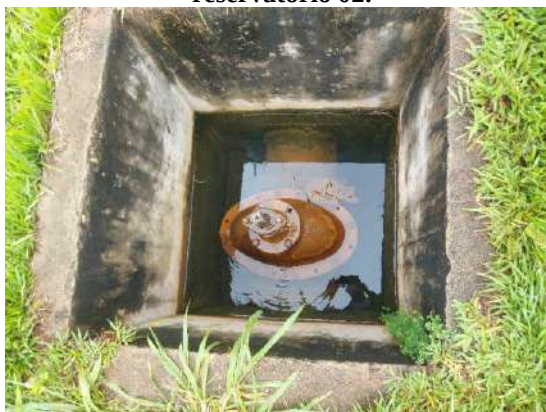
Figura 66 – Registro Gaveta DN 200 mm do tubo de saída do segundo compartimento do reservatório 02.
