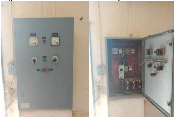
Figura 83 – Vista externa e interna do painel de comando.
