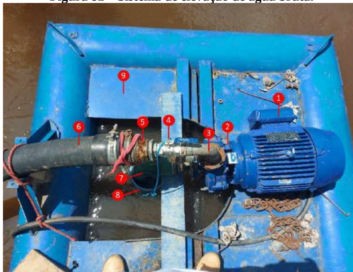
Figura 82 – Sistema de elevação de água bruta.
