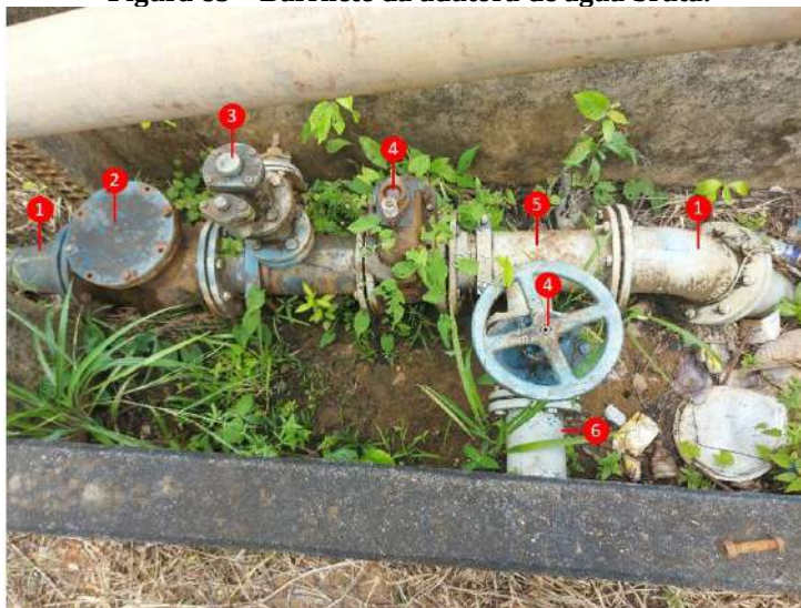
Figura 85 – Barrilete da adutora de água bruta.
