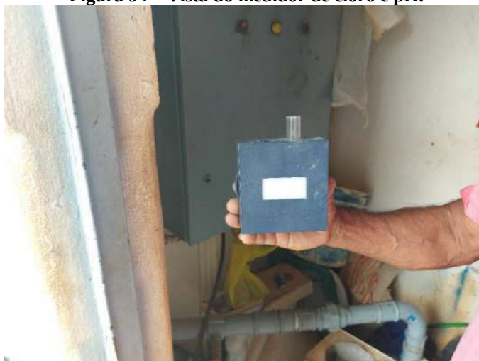
Figura 94 – Vista do medidor de cloro e pH.
