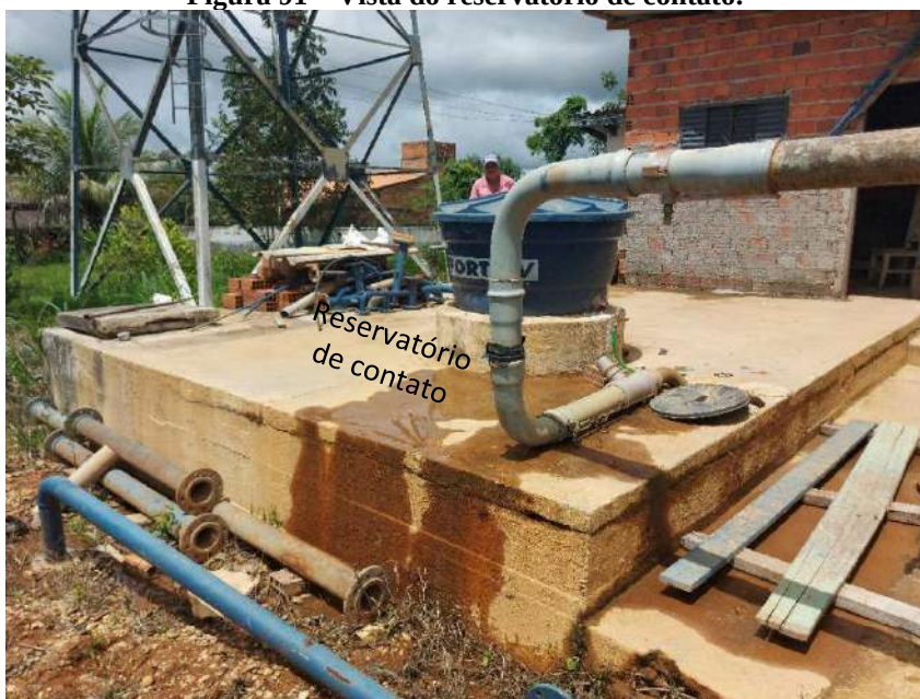
Figura 91 – Vista do reservatório de contato.
